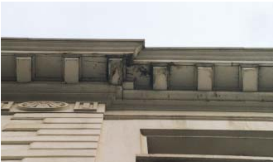
Schade aan kroonlijst door lekke dakgoot
