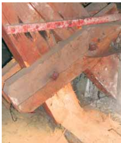
Schade aan spantbeen door huisboktor.
